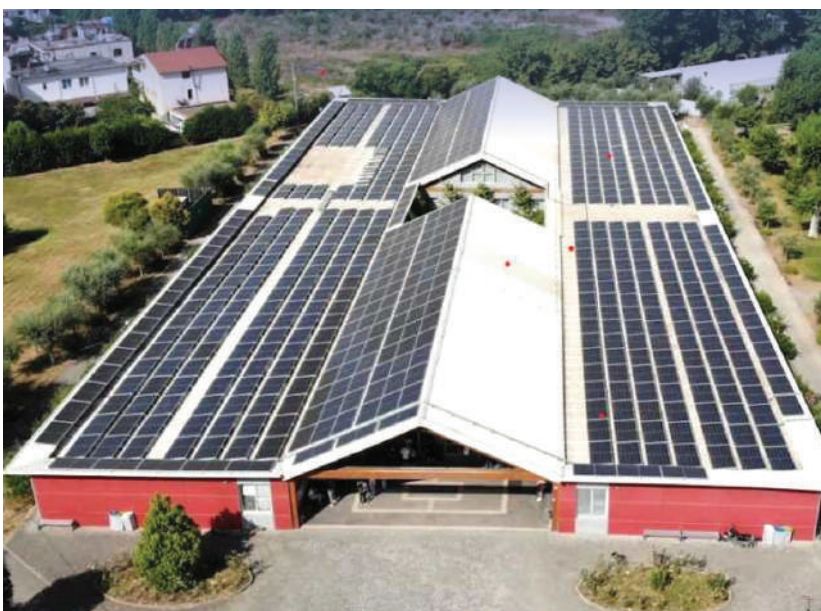
Uno degli impianti solari alla Università Cattolica di Tirana
